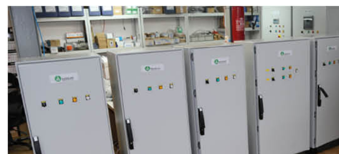
Szafy dozujące preparat do instalacji kominowych.
